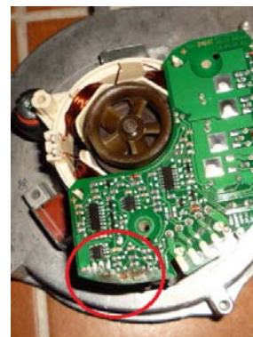
Beschädigtes Gebläse und E08 Störung.
