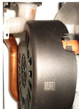
Ecoulement de condensats sur le ventilateur.
